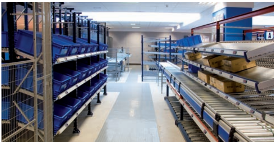
Instalación de dispositivos pick to light.
